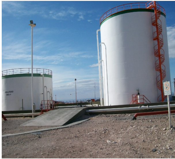
Planta de Tratamiento de Crudo
