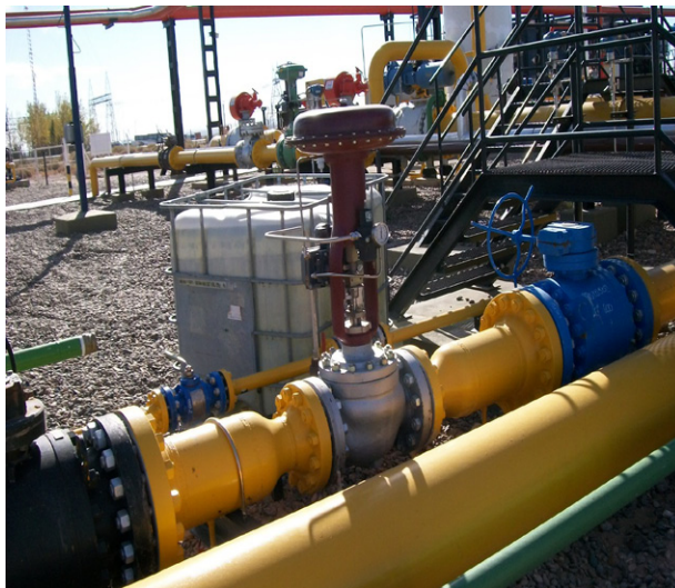
Anillo de Captación de gas
